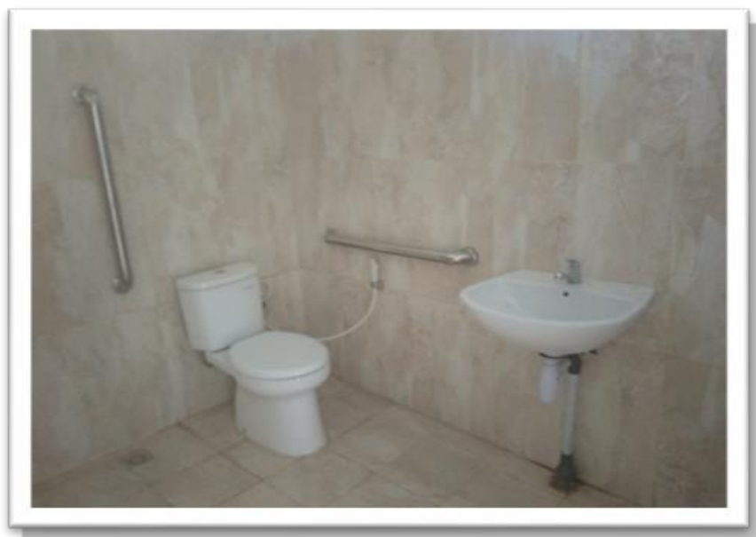
Gambar: Toilet Khusus Penyandang Disabilitas
