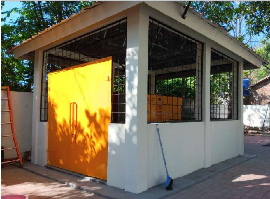
Gambar 5.35 Penyediaan genset dengan kapasitas mesin generator yang memadai untuk mengcover daya listrik seluruh gedung saat terjadi pemadaman listrik dari PLN .
