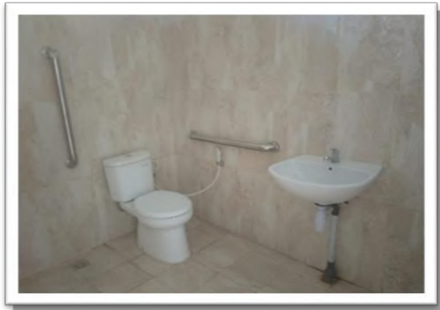
Gambar 5.29. Toilet Khusus Penyandang Disabilitas
