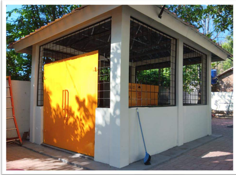
Gambar 5.43 Penyediaan genset dengan kapasitas mesin generator yang memadai untuk mengcover daya listrik seluruh gedung saat terjadi pemadaman listrik dari PLN .
