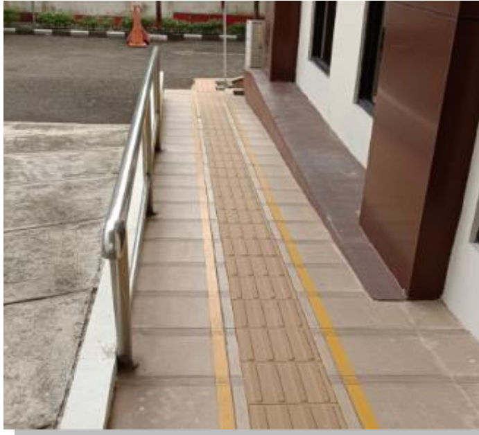
Gambar 5.26 guiding block (ubin pemandu) dan handraill ramp Penyandang Disabilitas
