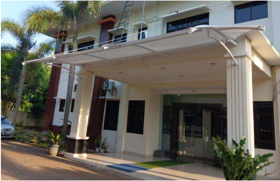
Gambar 5.38 Kanopi pada teras/lobby belakang kantor PTUN Serang Untuk mengurangi dampak tampias air hujan yang sering menggenang
